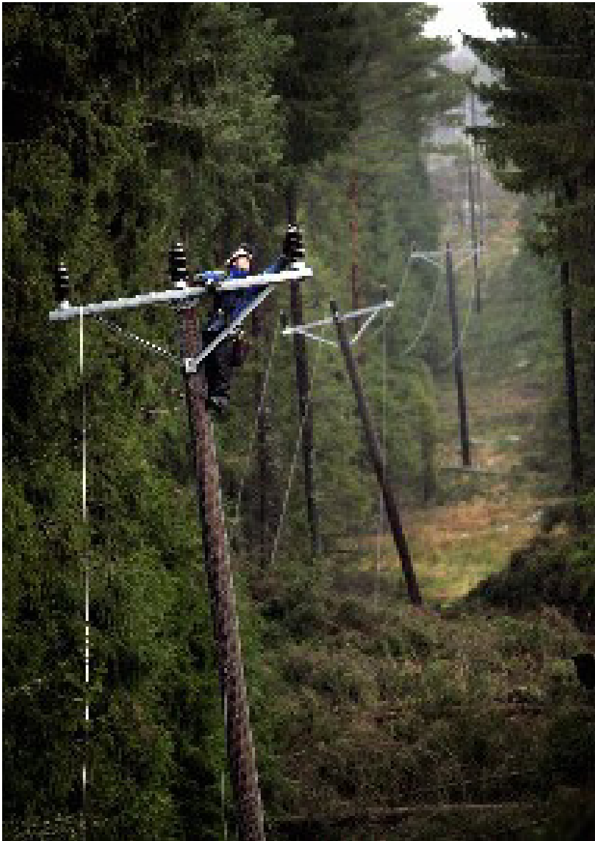
KUVIO 3. Voimajohtojen korjausta Bollebygdissä Gudrun-myrskyn jälkeen. Kuva: Niklas Larsson AFP/Lehtikuva.
